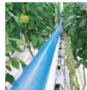
CO2局所施用子ダクト
