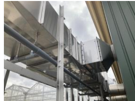
屋外集合ダクト
