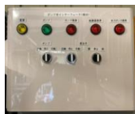
暖房給湯器制御盤
