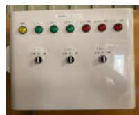
冷却塔制御盤
