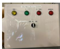
CO2給湯器制御盤
