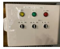
ポンプ制御盤
