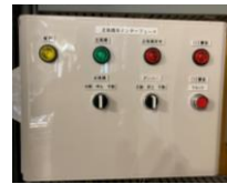
送風機制御盤
